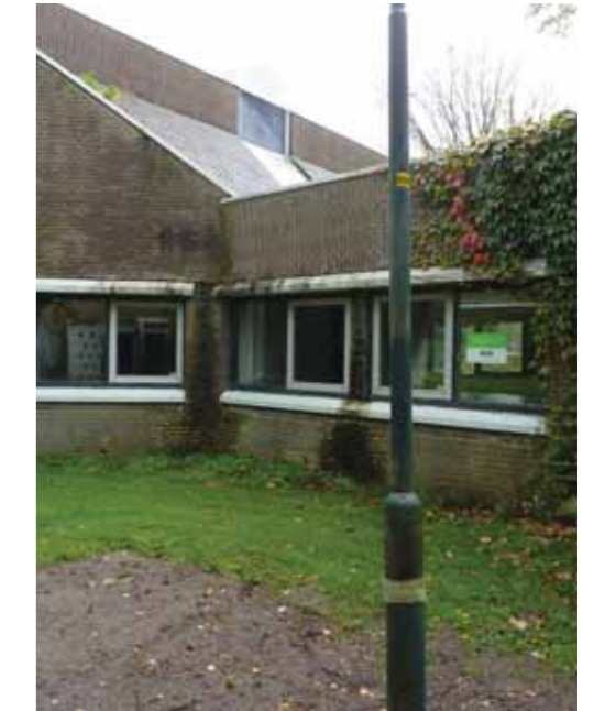
foto 22 Ter plaatse van de aansluiting uitbreiding noordvleugel zijn zowel binnen als buiten vochtproblemen.
