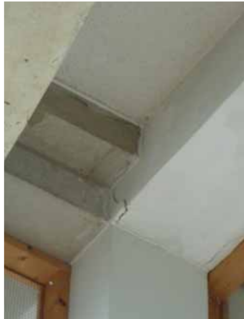
foto 1 Scheurvorming t.p.v. oplegging betonligger.
