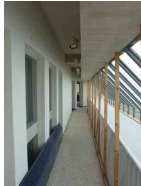
foto 2 Positie betonligger te laag t.p.v. gangzone verdieping.
