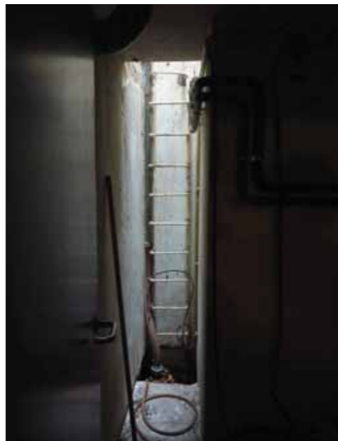
foto 8 Dompelpomp houdt de kelder droog. Een defecte pomp heeft in het verleden geleid tot waterschade in de kelder.
