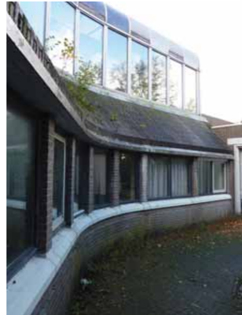
foto 19 De staat van het schuine metselwerk is slecht. Op enkele plaatsen is begroeiing aanwezig.
