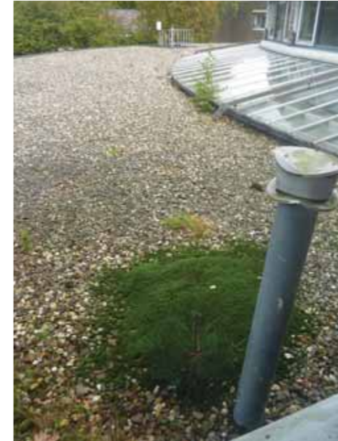
foto 13 Begroeiing platte daken leidt tot beschadiging dakbedekking en lekkage.
