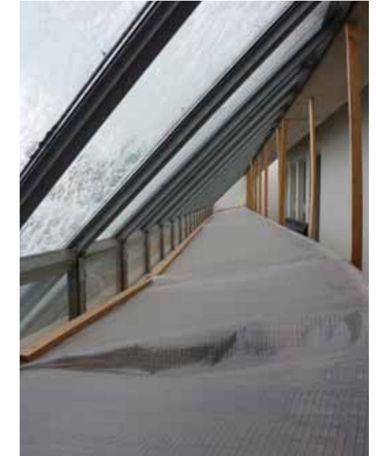
foto 14,15,16,17 Aan de buiten- of binnenzijde is zonwerende folie aangebracht welke erg is beschadigd en afgeschreven.
