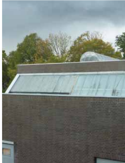
foto 11 Op een aantal plaatsen zijn glasruiten t.p.v. daklichten gescheurd / gebroken.
