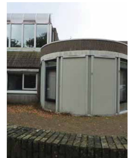
foto 18 Detailtering verdiepingshoge glaspuien: bij glasschade dient pui te worden gedemonteerd.
