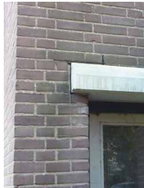
foto 23,24 Betonlateien en lekorpels zijn op meerdere plaatsen ontzet.
