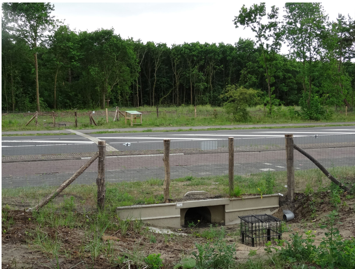
2 fauna tunnel onder Egmonderstraatweg
