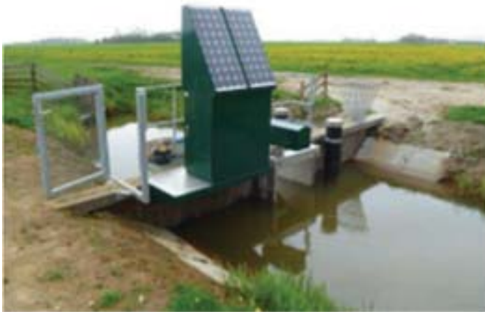
Foto B: voorbeeld geautomatiseerde stuw met zonnepaneel
