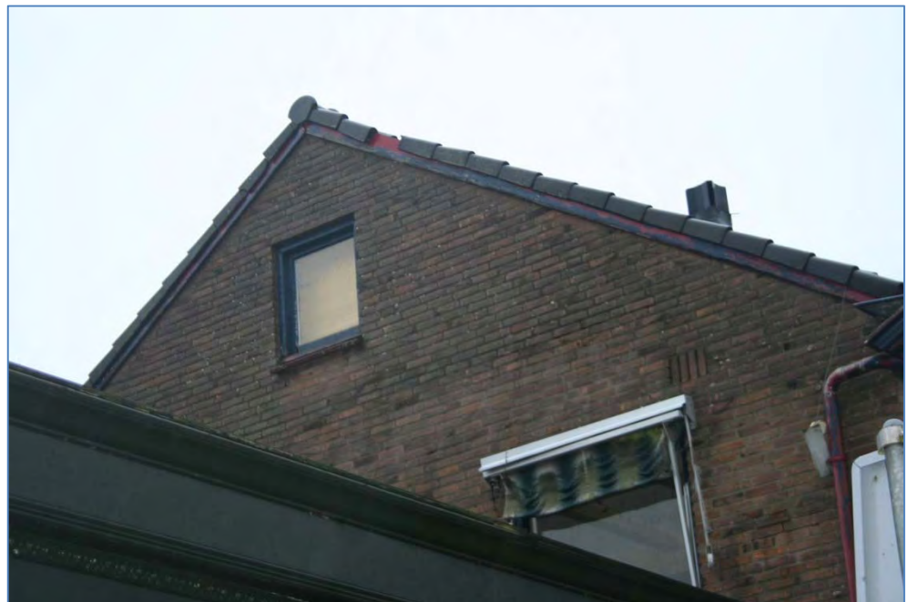
Gaten in de muren en ontbrekende dakpannen geven mogelijk toegang tot holtes die gebruikt kunnen worden door vleermuizen.
