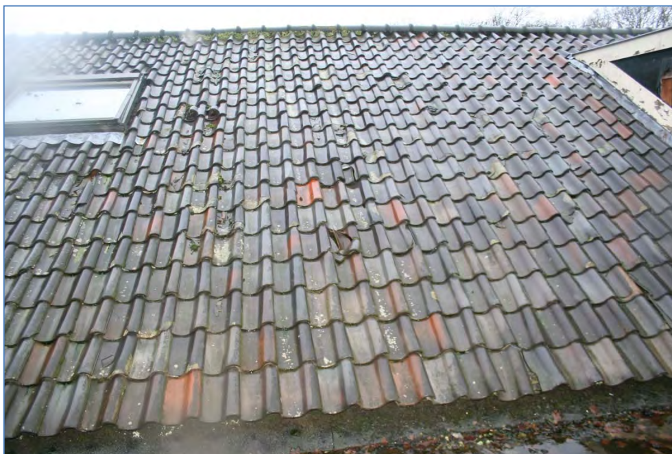
Beschadigde en ontbrekende dakpannen geven toegang tot de ruimte tussen de pannen en de betimmering.
