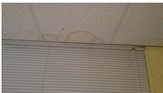
Diverse lekkage plekken plafonds ivm slechte staat dakbedekking
