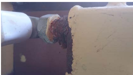
Corrosie aansluiting radiator
