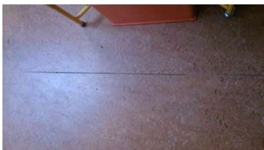
Ontbrekende naden linoleum
