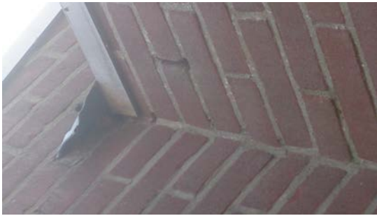
Slechte detaillering loodaansluitingen
