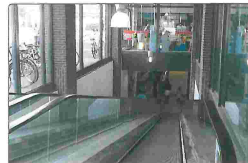
Referentie: tapis roulant naar parkeergarage
